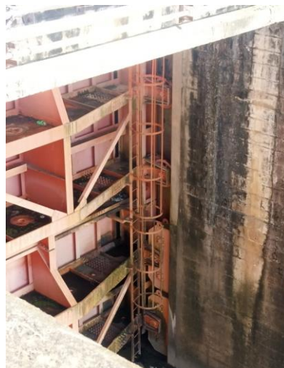
Gambar 3. Roller Gate (Sumber : Dokumentasi Pribadi Bendungan Serut)
